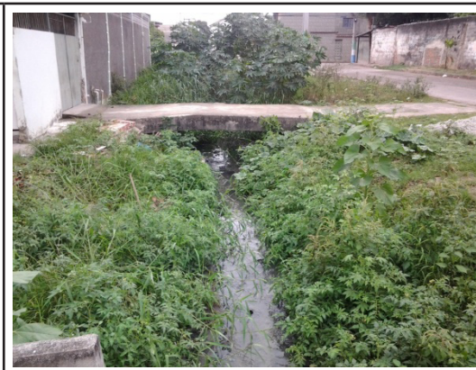
Figura 3.11-4.3-2: Córrego Grande Rio, já próximo ao seu lançamento no Rio Sarapuí, com grande presença de mato e assoreamento na sua calha comprometendo a capacidade de escoamento.
