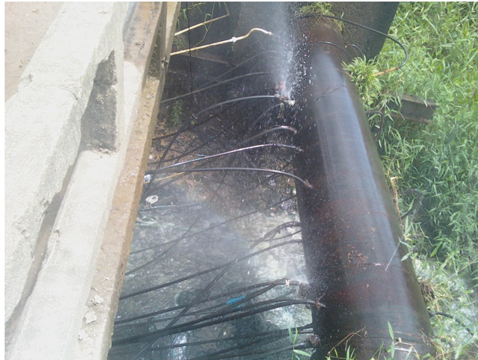
FOTO: Derivações clandestinas (gatos) em sub-adutora de água.
